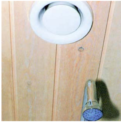
Figur 2. Udsugningsventil i loft til mekanisk ventilation.
